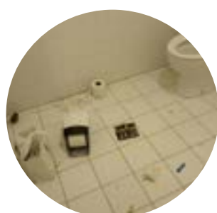
Toilettes publiques (Place des Pins) vandalisées
