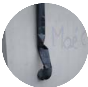
Descente d'eau pluviale en zinc tordue La Passerelle
