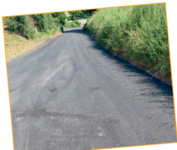
Réfection des enrobés sur le haut du chemin de la Balmière et busage du fossé suite aux intempéries de fin d'année 2022
