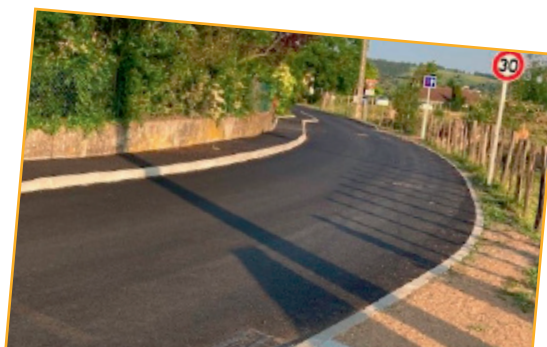
Chemin de Montcher entre la RD70 et le chemin de la Chaux, réfection de l'enrobé et création de trottoirs pour faciliter le déplacement des piétons.
