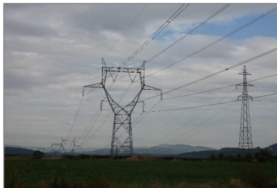
Couloir de lignes électriques
